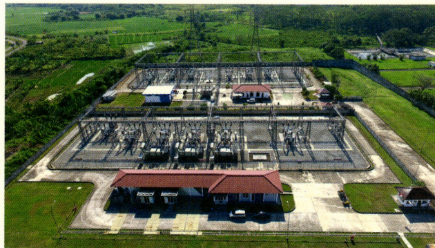
電力供給施設
